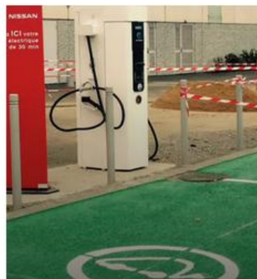
Infrastructure de recharge de véhicule électrique
