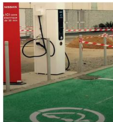
Infrastructure de recharge de véhicule électrique
