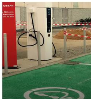
Infrastructure de recharge de véhicule électrique
